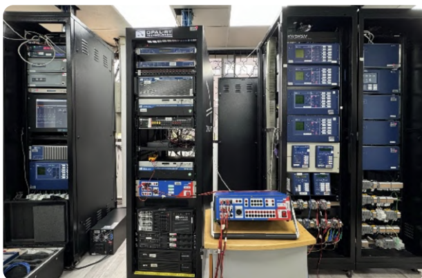
Figura Nro. 2.1: Laboratorio de Simulación Digital en Tiempo Real del Operador Nacional de Electricidad (CENACE).
