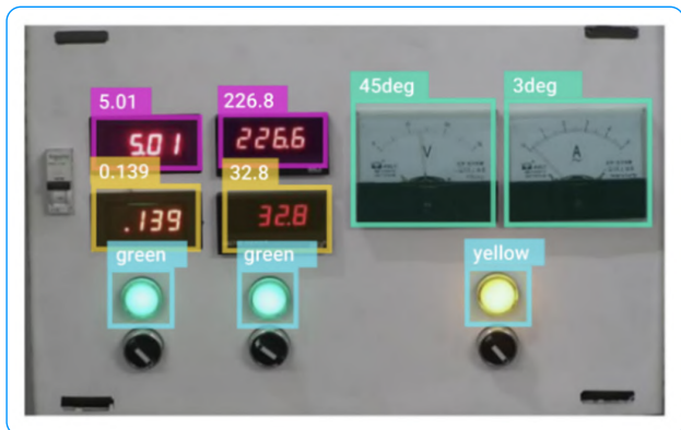
Figura Nro. 1.5: Detección automática de valores numéricos, luces e indicadores analógicos en panel eléctrico mediante visión artificial [8].
