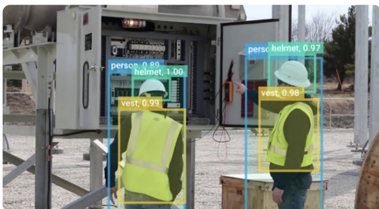
Figura Nro. 1.6: Detección de personas y EPP en subestaciones mediante visión artificial [8].
