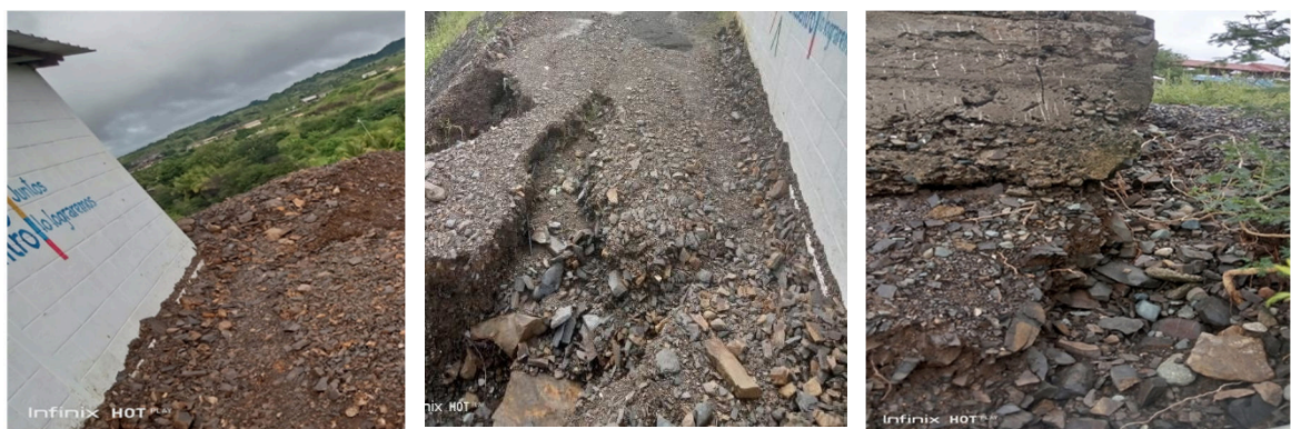
Figura 33. Afectaciones Centro de Desarrollo Infantil
