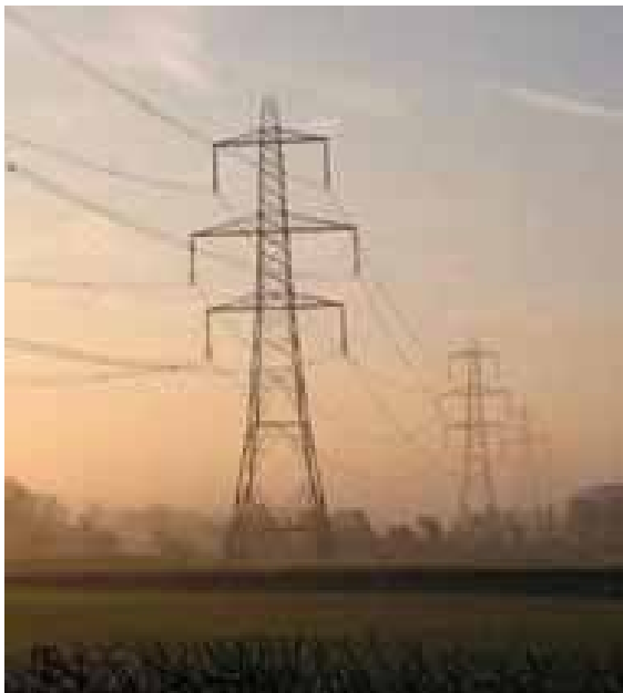
Figura 3-1: Torres de Transmisión de Transelectric S.A.
